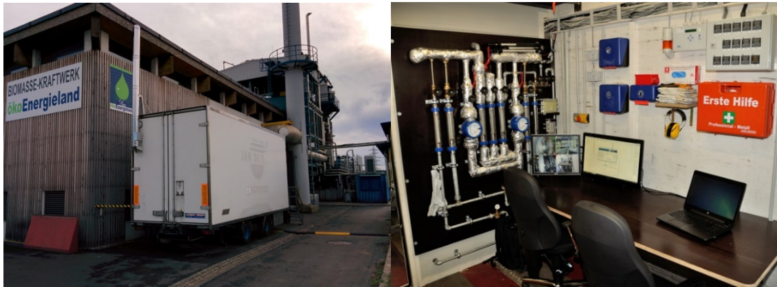
Abbildung 2: mobile TSA Anlage [4]
